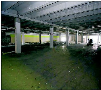
Ende September soll im ehemaligen Wasgau-Markt ein neues Fitness-Center eröffnet. Die Bauarbeiten laufen seit Anfang August.
